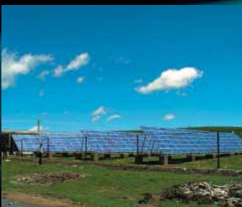
Petite installation de production d'énergie
