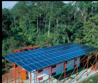
Station de base de télécommunications
