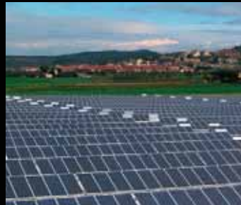
Petite installation de production d'énergie
