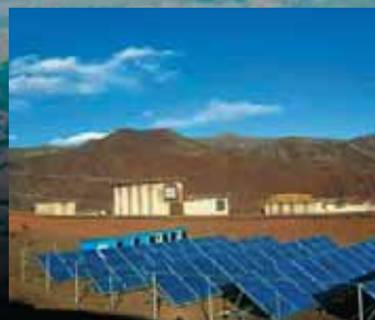
Petite installation de production d'énergie
